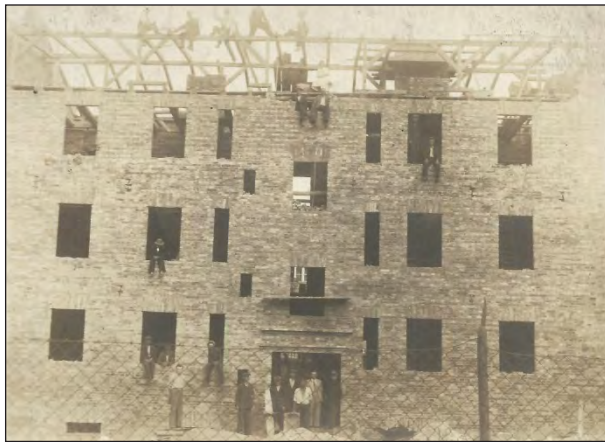
Zdjęcie 33. Budowa koszar dla II dywizjonu 4. pac w Tomaszowie Maz. – wiosna 1935 r.
