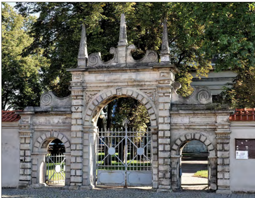
106. Koniecpol, kościół parafialny, brama główna ogrodzenia od strony rynku. Fot. P. Gryglewski.
