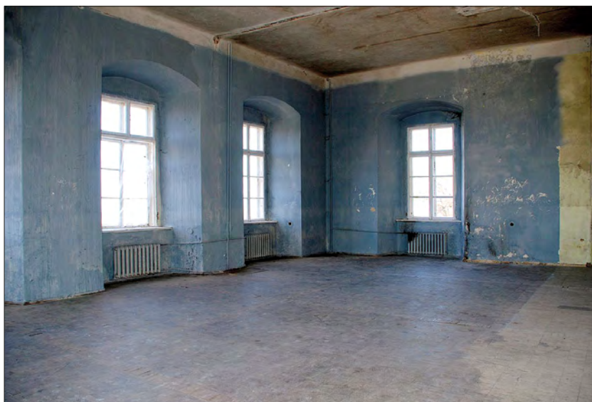
76. Podhorce, pałac, izba stołowa na pierwszym piętrze pawilonu wschodniego. Fot. Z. Bania.
