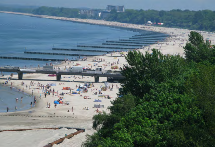
Ryc. 4.25. Prace sprzyjające gromadzeniu piasku na plaży w Kołobrzegu. Na pierwszym planie dowóz piasku, a na drugim drewniane ostrogi wymuszające akumulację
