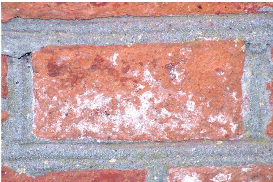
Ryc. 8.11. Wykwity soli na powierzchni cegły w dolnej części budynku
