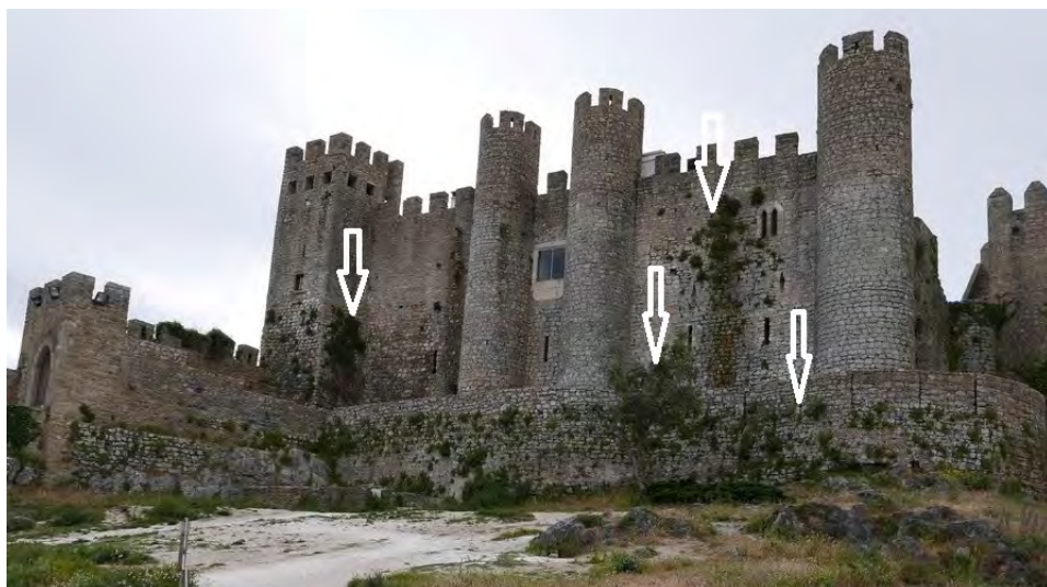
Ryc. 8.13. Niszczenie murów i ścian w wyniku rozwoju porostów i traw, przykład z Portugalii
