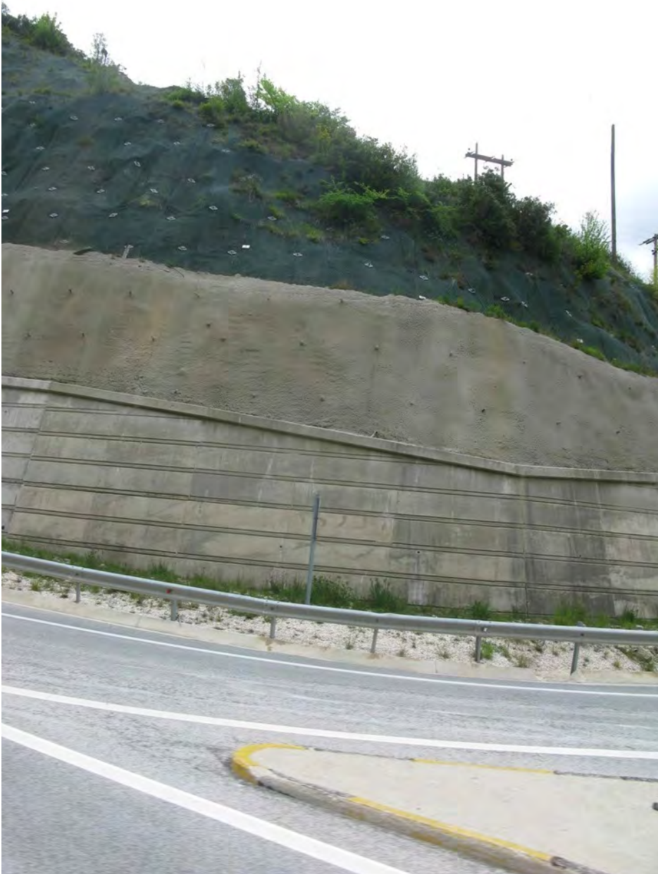
Ryc. 7.7. Stok zabezpieczony przed odpadaniem – w dolnej części mur oporowy, a w górnej siatki
