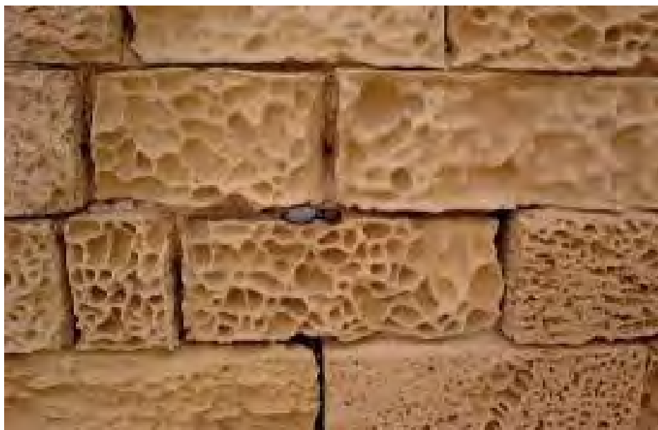
Ryc. 8.16. Kawernizacja (dziurawienie skały) jako efekt wietrzenia solnego i chemicznego w kamieniu budowlanym na Malcie
