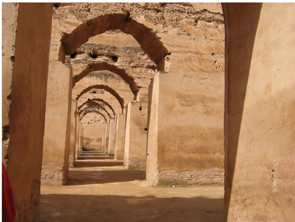
Ryc. 8.9. Łuszczenie i rozkruszanie kamienia oraz tynku w wyniku wietrzenia solnego w strefie wzniosu kapilarnego, przykład z Maroka
