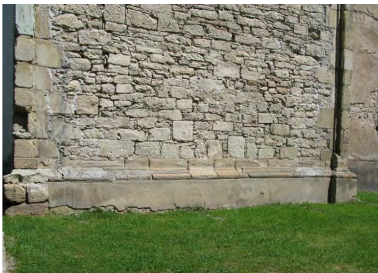
Ryc. 8.5. Niszczenie kamienia budowlanego w wyniku wietrzenia mrozowego oraz łuszczenie i opadanie tynku na styku z gruntem w wyniku podsiąku kapilarnego wody
