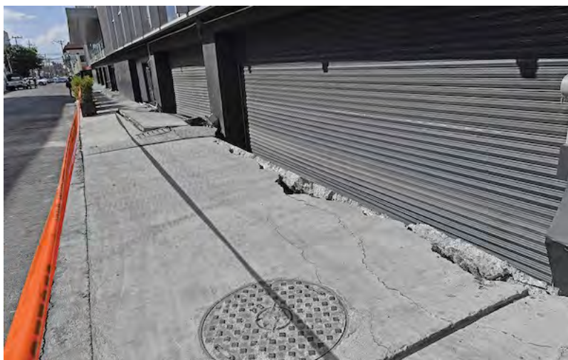
Ryc. 5.12. Uszkodzone fundamenty budynku i płyty chodnikowe w wyniku osiadania terenu w Meksyku
