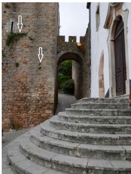
Ryc. 8.12. Rozwój roślinności na murze powoduje jego powolne niszczenie Na kamiennych schodach rozwijają się w koloniach różne drobnoustroje, przykład z Portugalii
