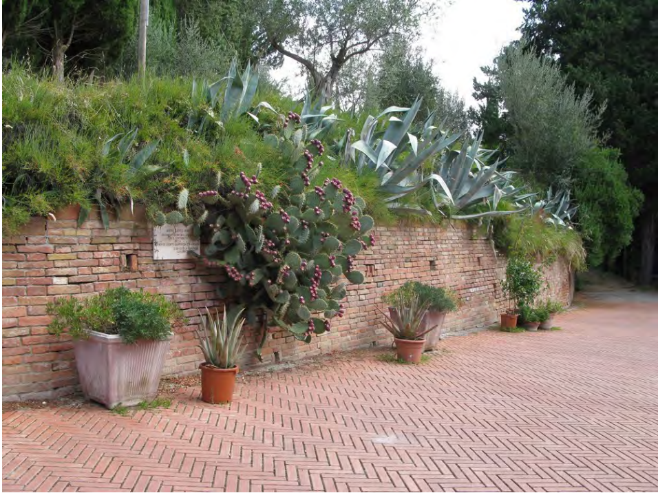
Ryc. 7.17. Niski mur oporowy zabezpieczający parking – w murze widoczne są okienka umożliwiające wypływanie wód gruntowych podczas opadów
