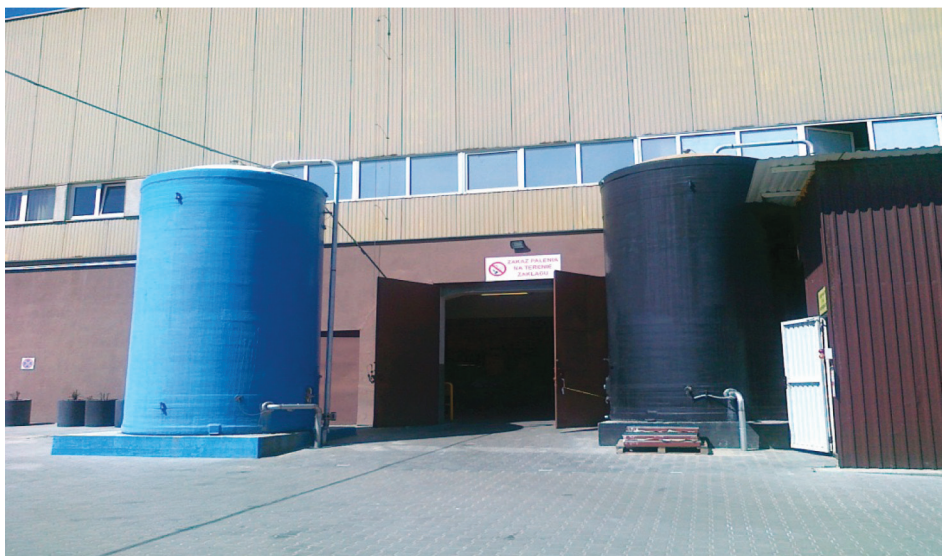
Fot. 13. Zbiorniki buforowe stojące przy ozonowni
