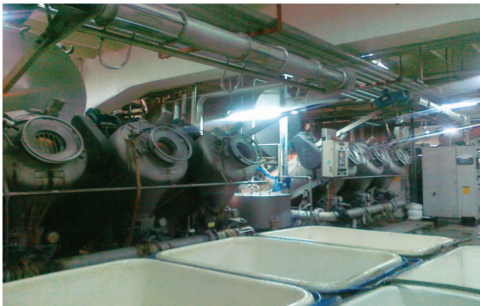
Fot. 7. Barwiarki firmy Thies jako elementy instalacji ozonowania
