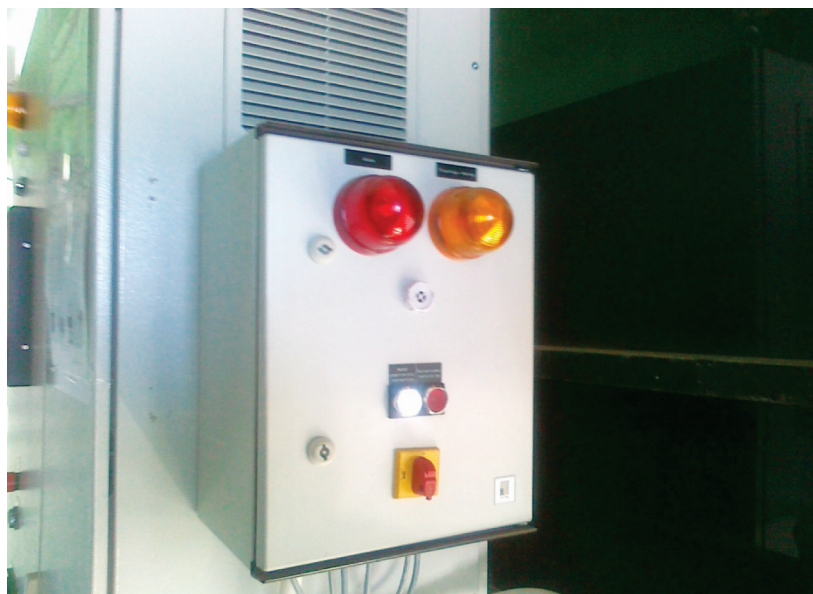
Fot. 9. System sygnalizacji wewnątrz pomieszczenia
